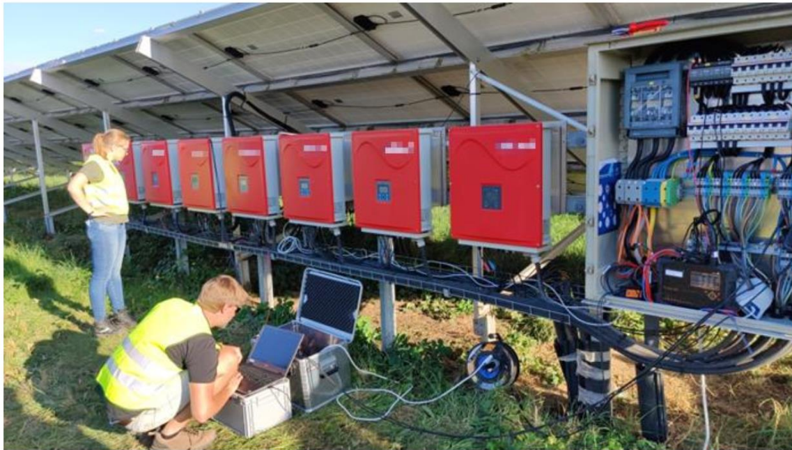
Abbildung 7: Umrichtergruppe bestehend aus insgesamt 8 Wechselrichtern (hier inkl. WR20 und WR22) an einem Anschlusskasten (rechts)
